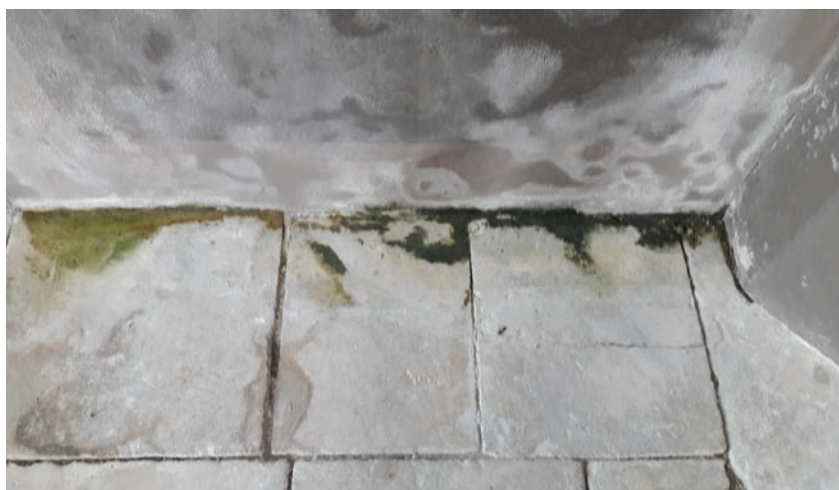
▲ Vochtplekken, afbladderende verf en op de basementen van de pilasters is er zelfs mosaangroei te zien.
